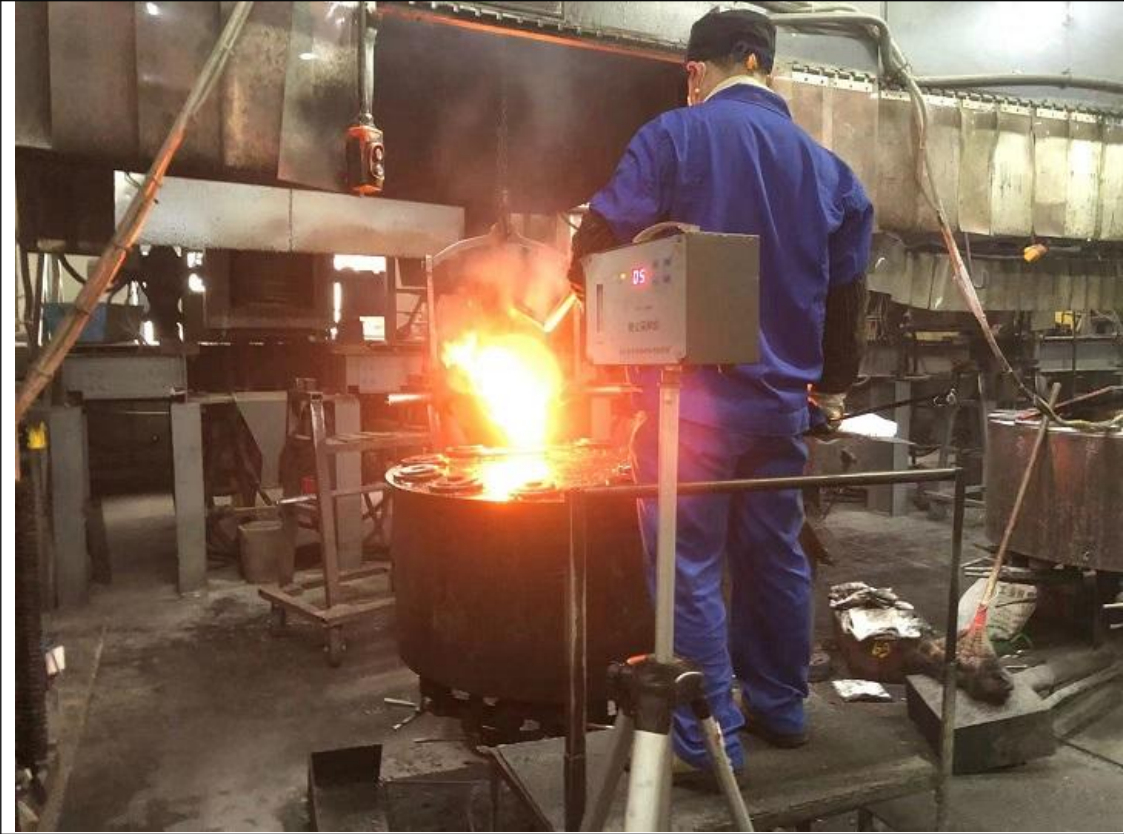
备注：新厂区2#厂房1F，浇铸岗位
